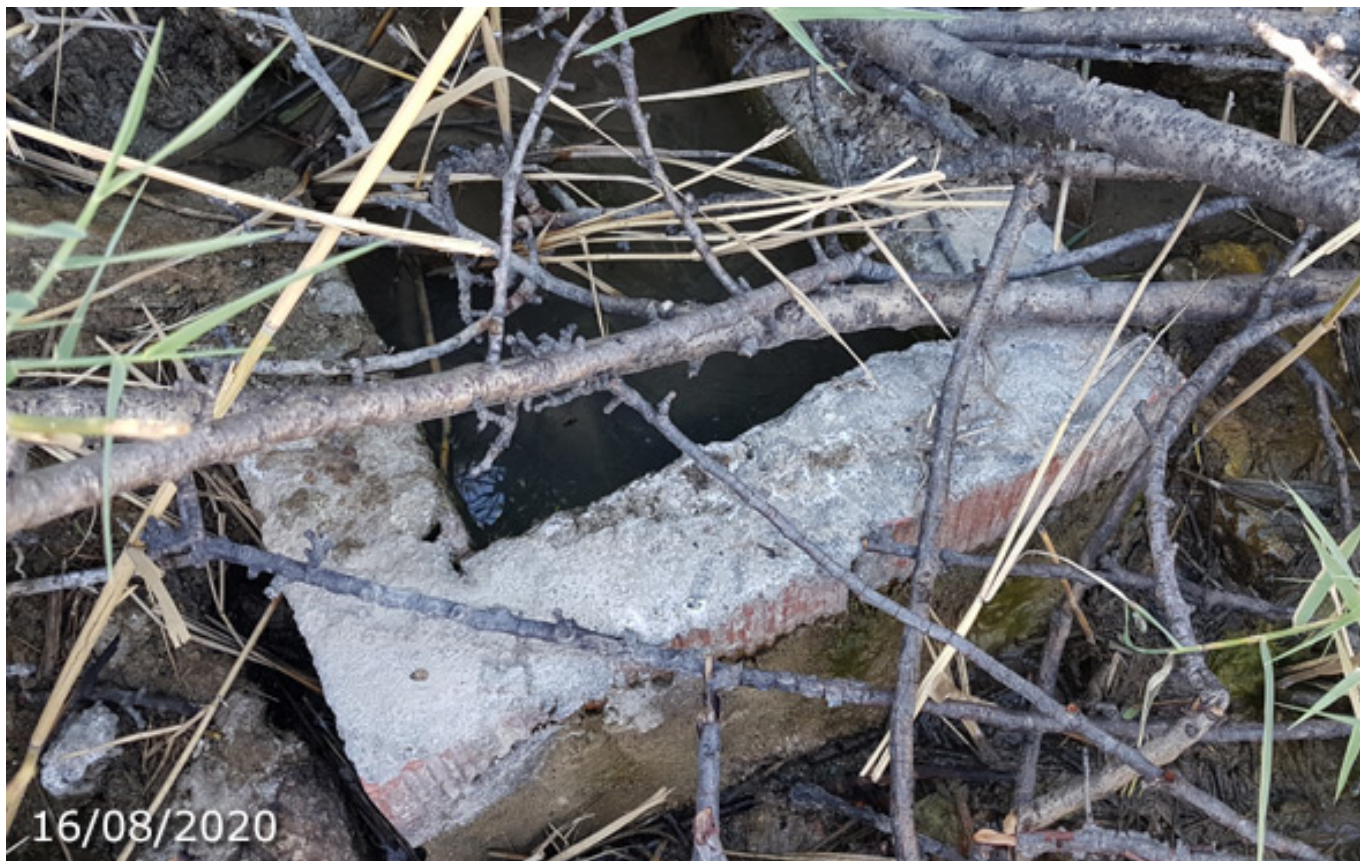
Arqueta de captación de las aguas entubadas, en el camino de Los Bañuelos (A. Ventas, agosto 2020)
