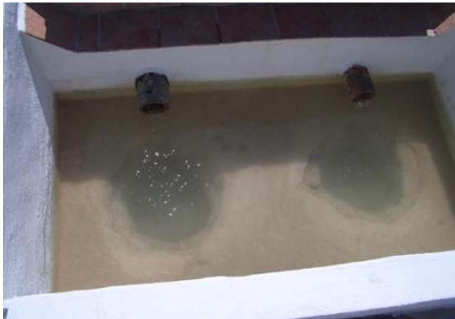
Detalle de la decantación del agua
