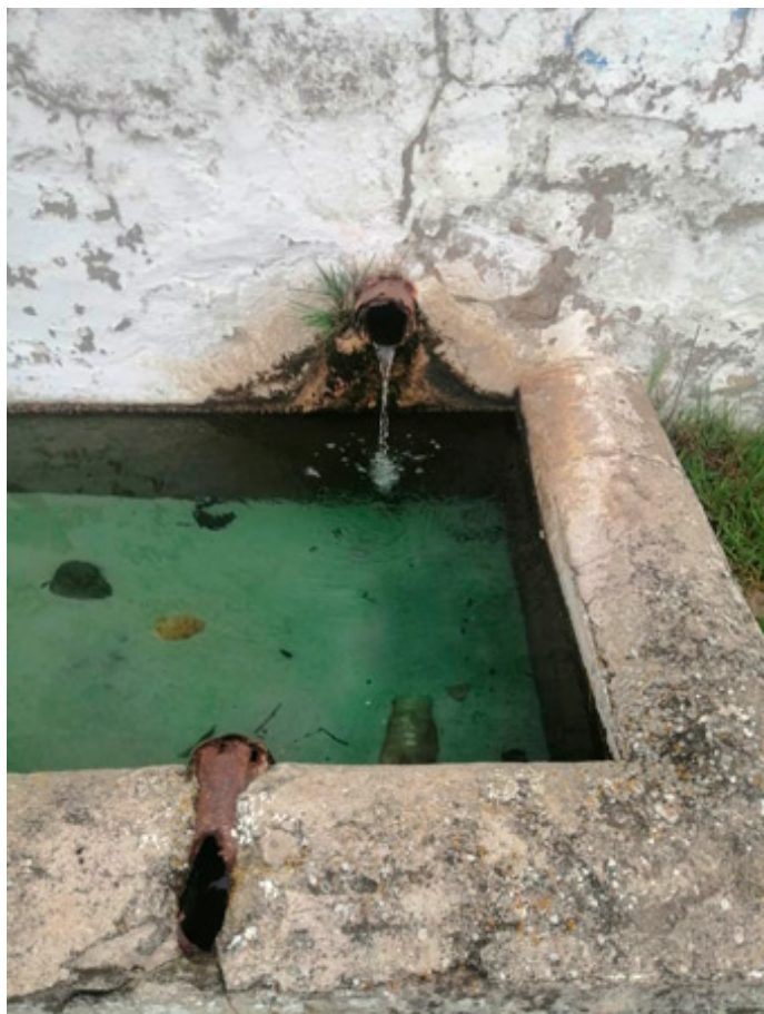
Caño de agua y salidero del pilar (J. Perales, marzo 2020)
