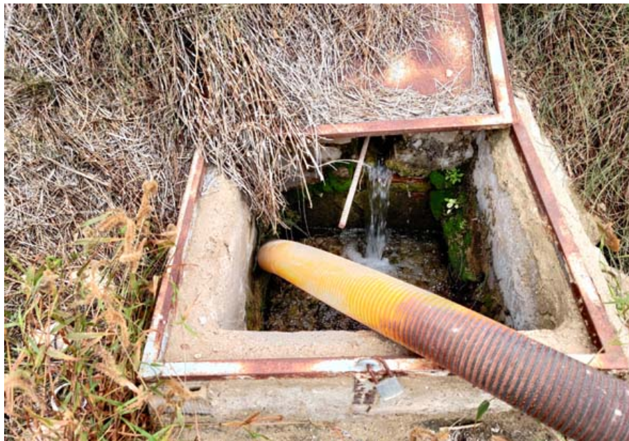
Arqueta del Cortijo Barahona que presenta el mayor caudal del manantial (D. Sánchez Garrido, octubre 2020)
