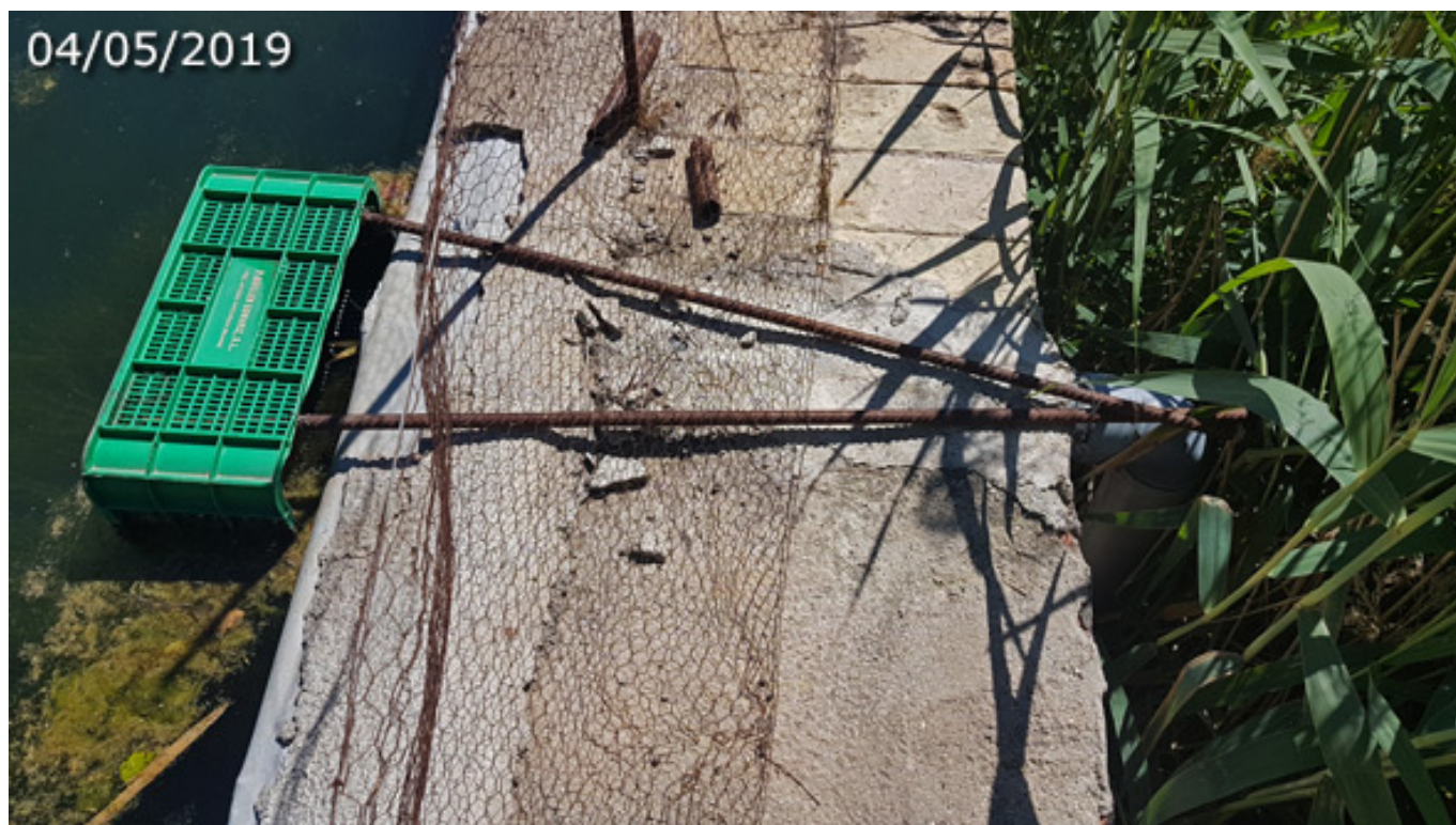
Rebosadero de alberca, con rudimentario sistema de filtrado (A. Ventas. mayo 2019)
