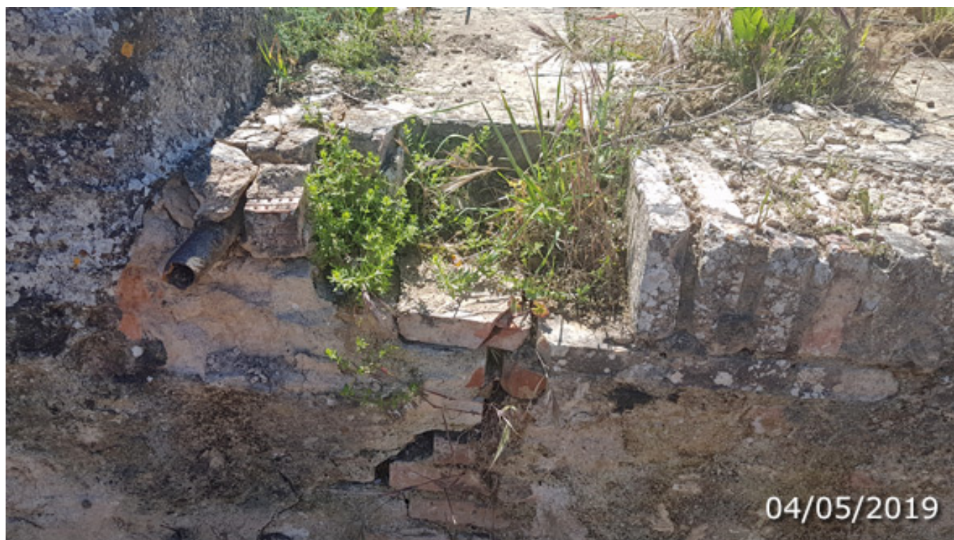
Detalle del caño de hierro por el que debería salir el agua del pilar (A. Ventas. mayo 2019)
