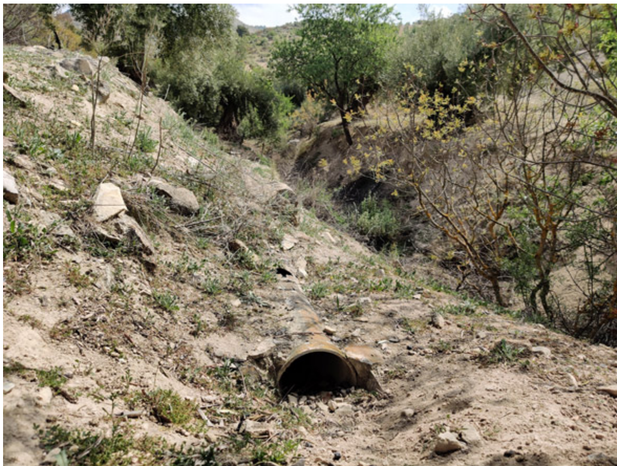
Restos de la canalización por el barranco junto al Zarzalejo (D. Sánchez Garrido, abril 2021)
