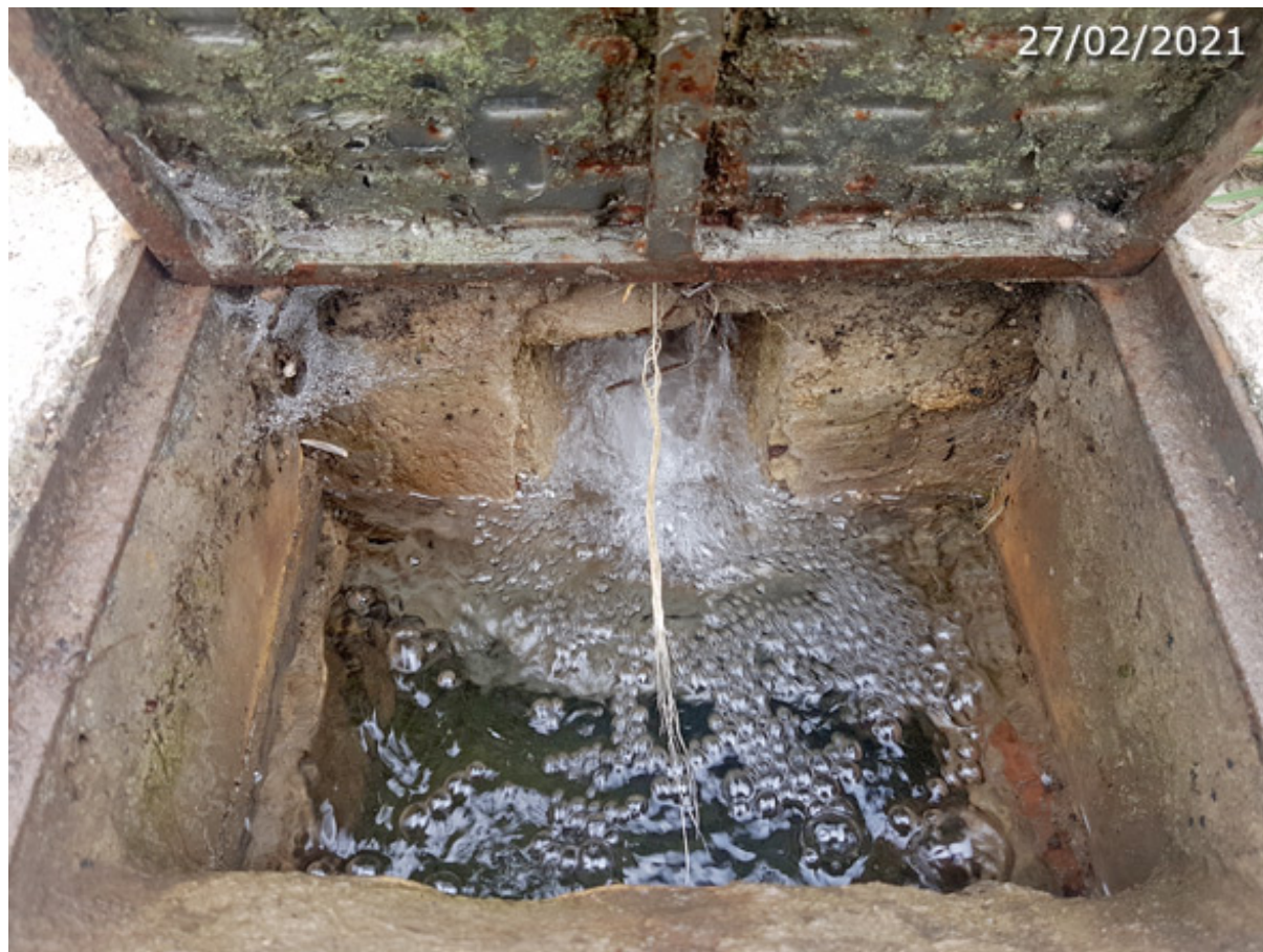
Interior de la arqueta con las aguas sobrantes del pilar (A. Ventas, febrero 2021)
