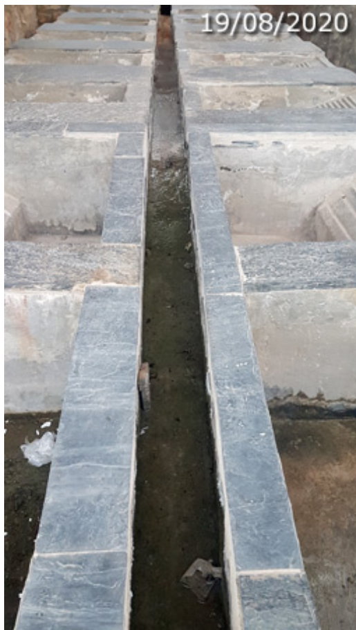
Canal de agua para abastecimiento de las pilas en el lavadero (A. Ventas, agosto 2020)
