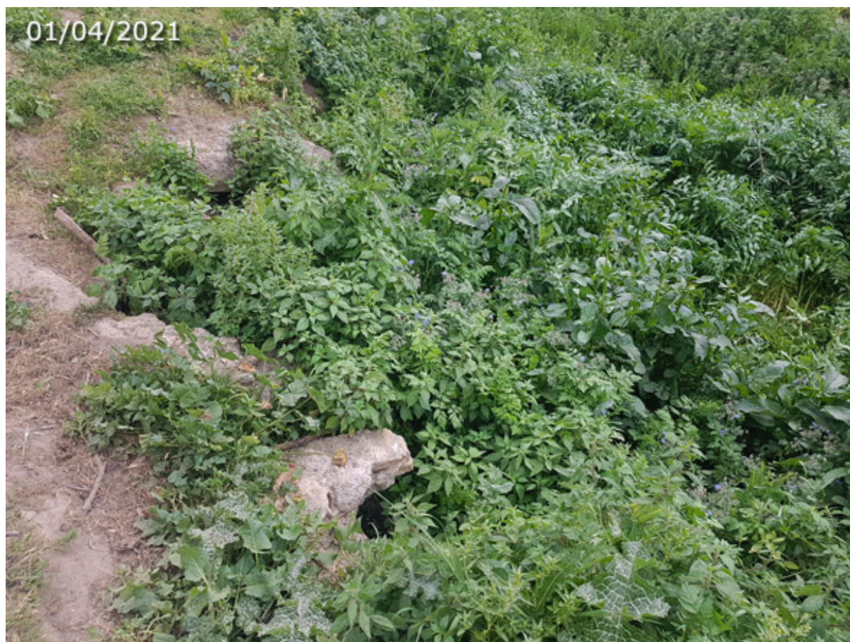
Vegetación creciendo dentro del estanque naturalizado (A. Ventas, abril 2021)
