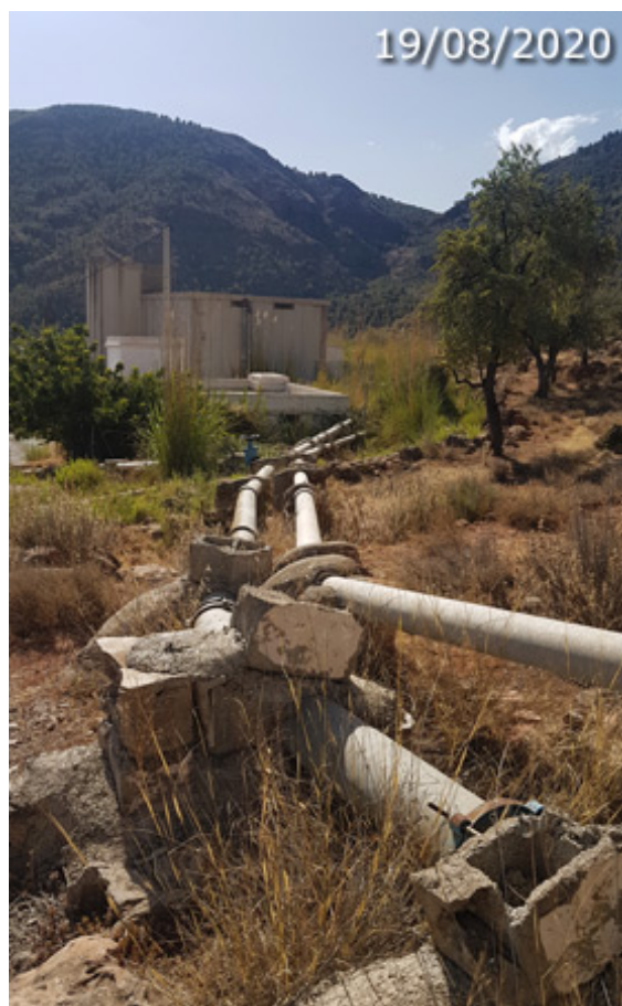
Depósitos de Alcora, al fondo, hasta los que llegan las conducciones de Fibrocemento (A. Ventas. agosto 2020)
