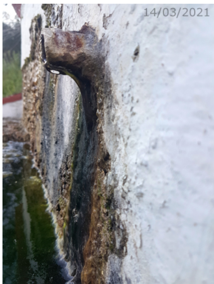
Caño rezumando agua que termina por discurrir por la pared (A. Ventas, marzo 2021)
