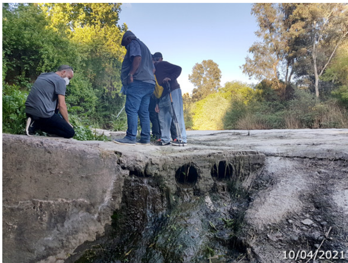
Aguas del manantial de La Caja saliendo por una fisura en el azud. Al fondo, voluntarios observan la rotura con Manuel Navarrete a la derecha (A. Ventas. Abril 2021)
