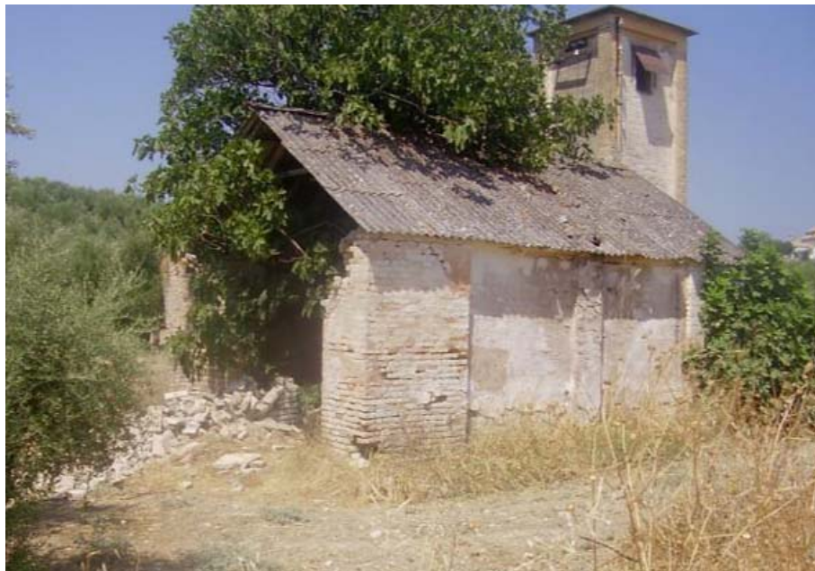
La Fuemblanquilla II, se observa el mal estado en que se encuentra la caseta de protección (M. Cala, julio2006)
