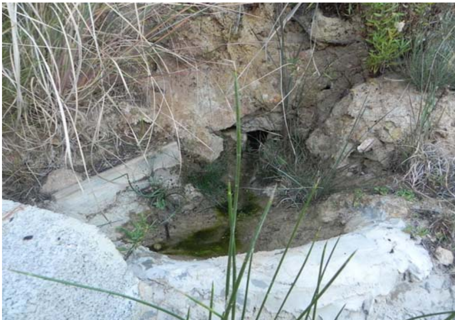
Pequeño pilar donde la tubería de goma el agua (J. Martín, octubre 2013)
