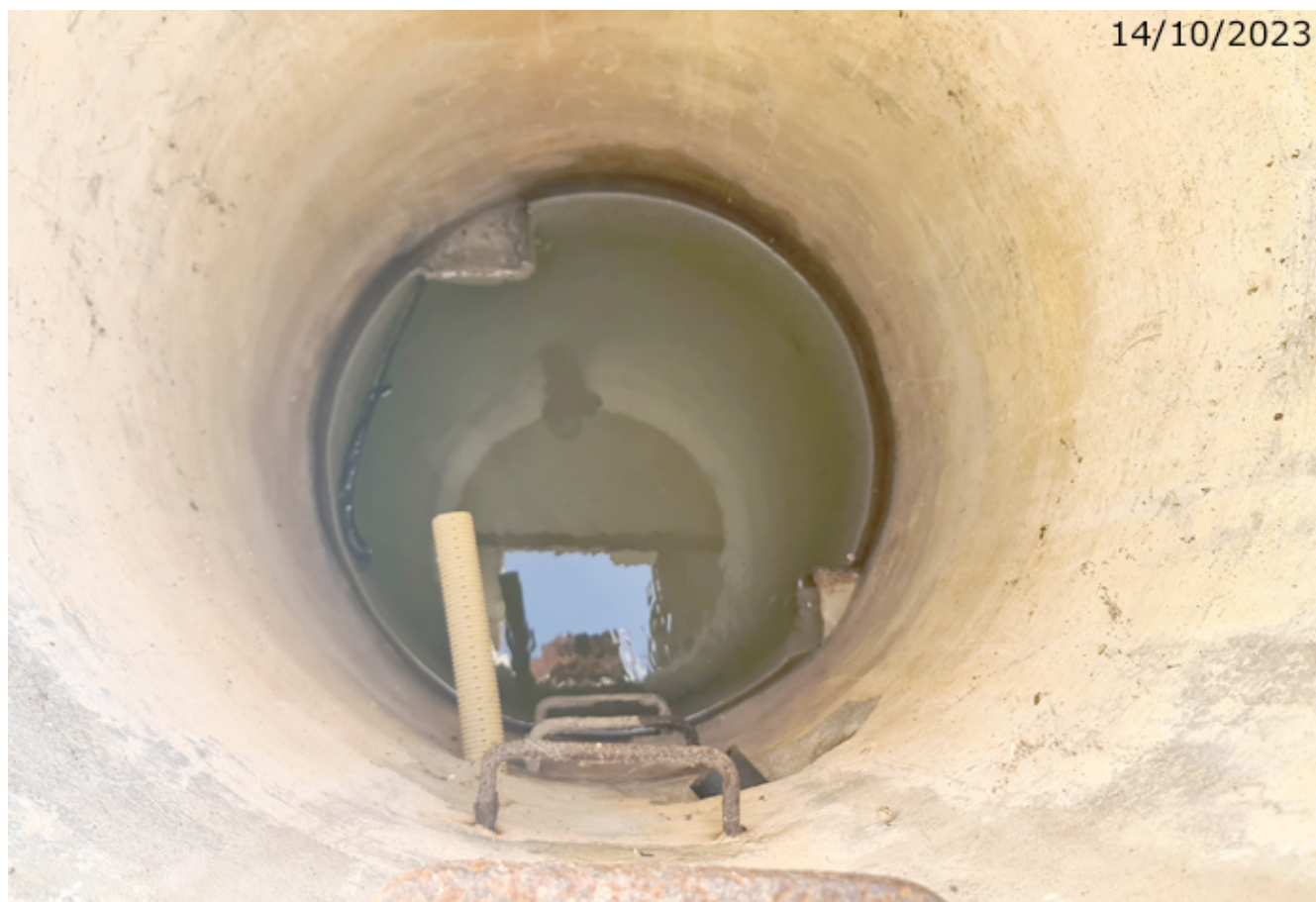
Interior del pozo final, con entrada de agua por la derecha y salida por la conducción superior (A. Ventas, octubre 2023)
