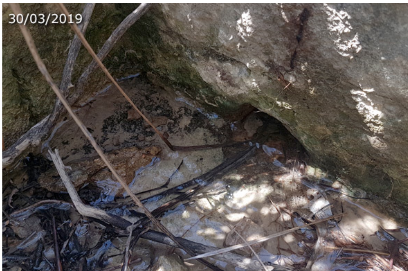
Salida sin tapar del agua del pilar, por la que se pierde ladera abajo (A. Ventas, marzo 2019)
