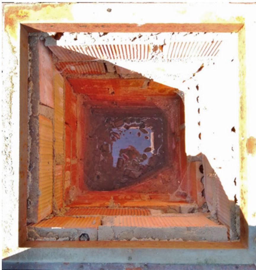
Interior de arqueta con el pequeño rezume y salida a la fuente (C. Cano, mayo 2020)
