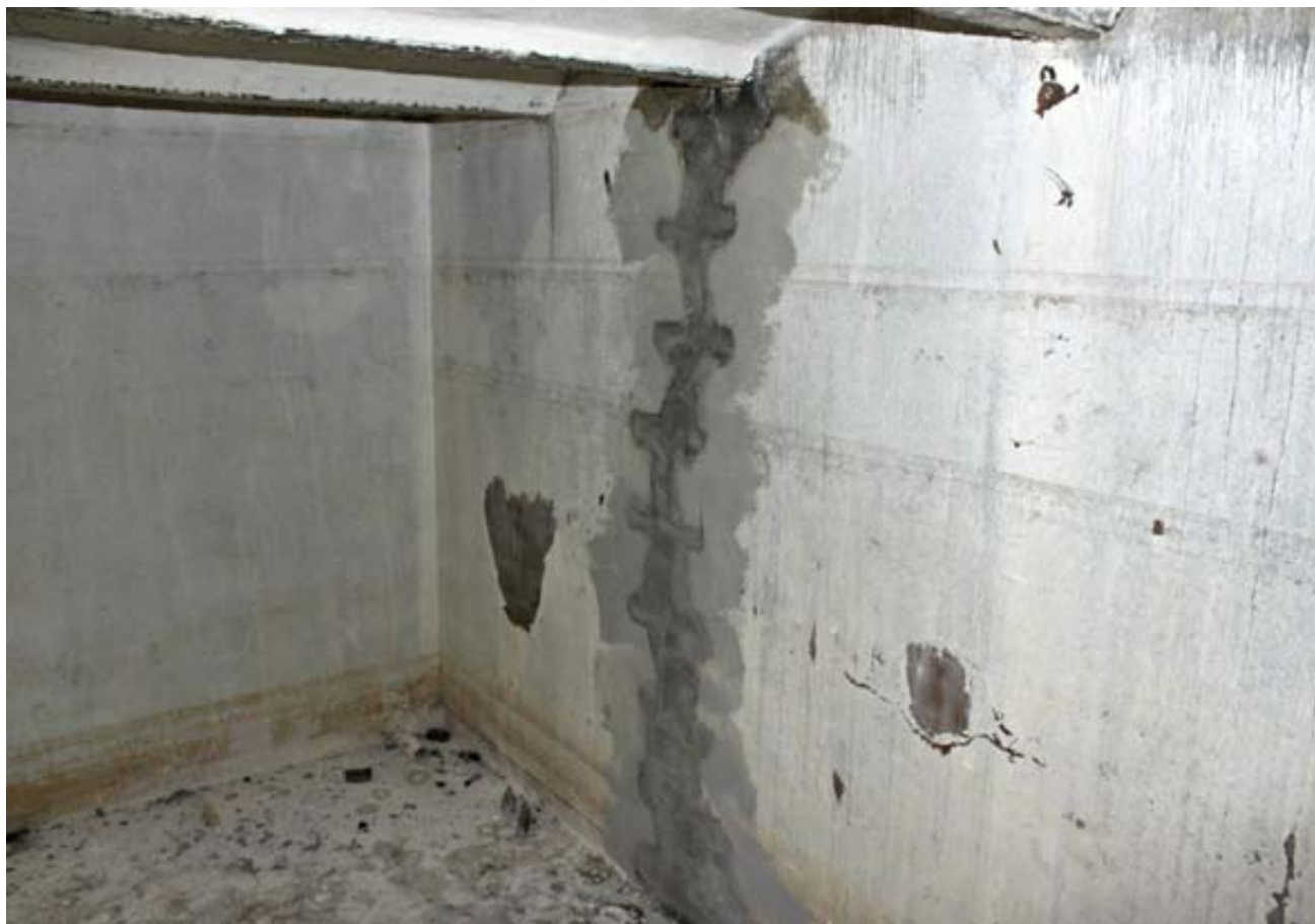
El depósito o aljibe tiene una capacidad total de 31.500 litros. (Autor: Ayuntamiento de Fuerte del Rey, junio 2012)
