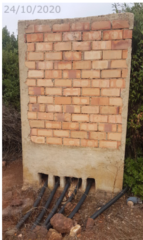
Caseta de llaves de paso para el reparto de las aguas de riego (A. Ventas, octubre 2020)
