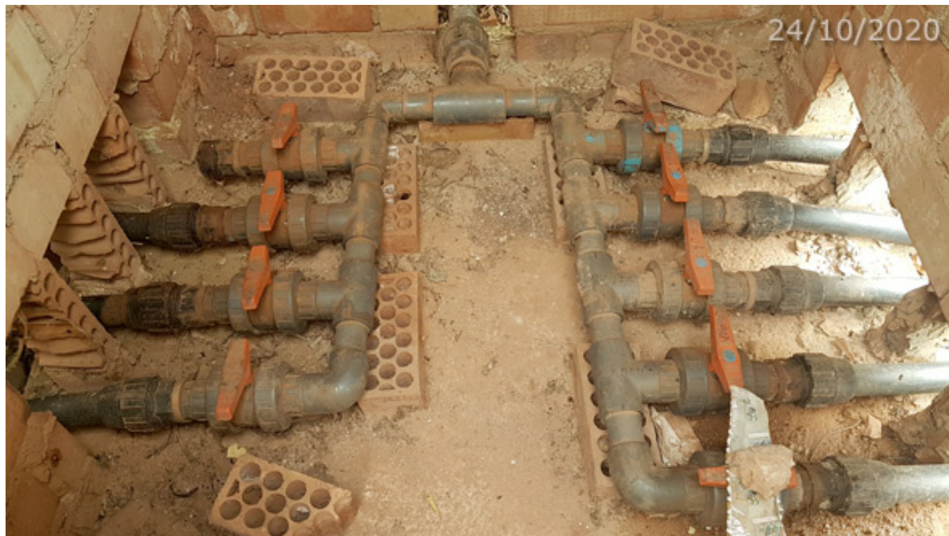
Interior de las llaves de paso de reparto de las aguas de riego en la caseta (A. Ventas, octubre 2020)
