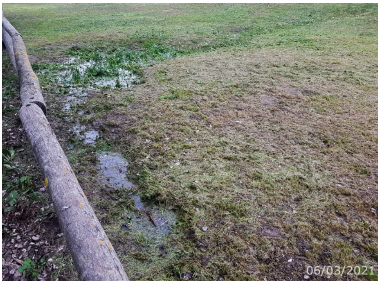
Reguero de agua generado por el rezume en el vallado del Guadaira, tras el desbroce de la zona (A. Ventas, marzo 2021)
