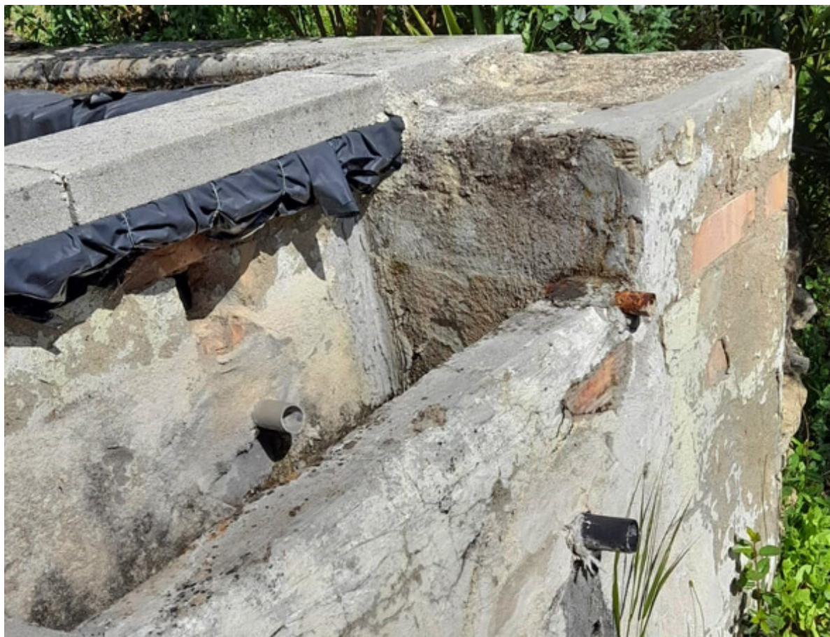
Detalle de los caños de entrada/salida de agua en la pileta (A. Jiménez, abril 2021)
