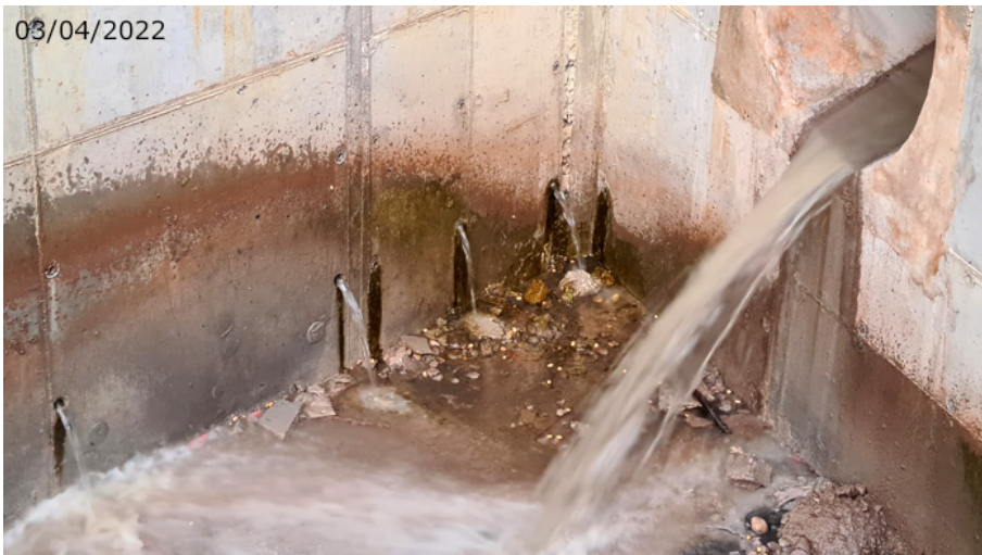
Chorros de agua por los drenajes del encofrado (A. Ventas, abril 2022)
