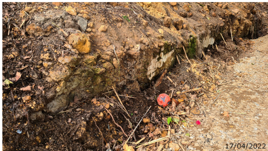
Muro de pared donde se originan algunos de los rezumes (A. Ventas, abril 2022)
