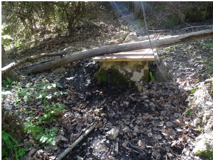
Vista de la arqueta que recoge las aguas de los manantiales (J. F. Martín Álvarez, abril 2023)
