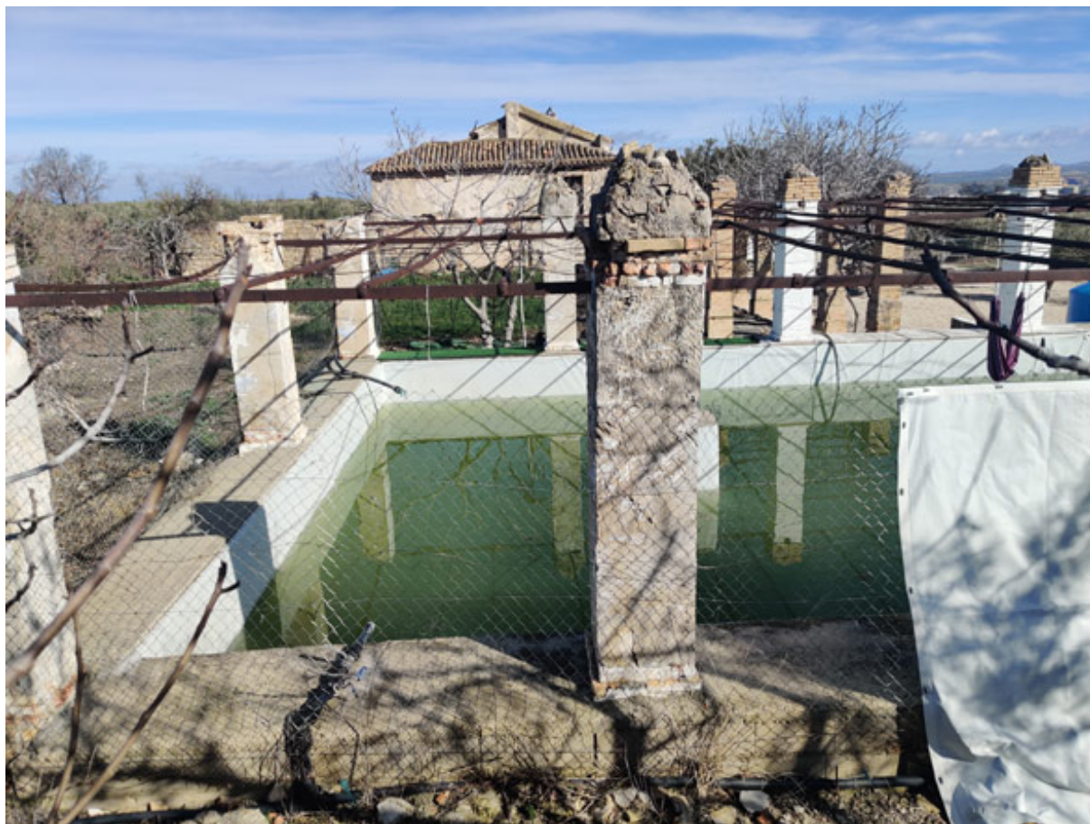
Alberca impermeabilizada y tubería que aporta el caudal. (D. Sánchez Garrido, enero 2021)
