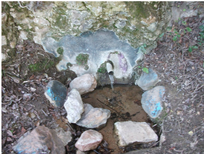
Fuente tras la supuesta reparación de los operarios del AVE (Manuel Trujillo, octubre 2022))
