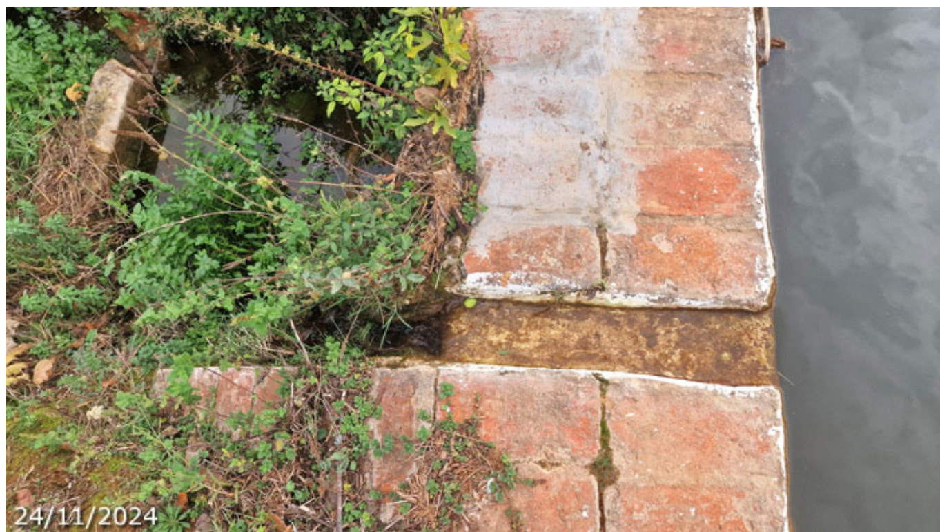
Rebosadero entre el enlosado de ladrillos del borde de la alberca (A. Ventas, noviembre 2024)
