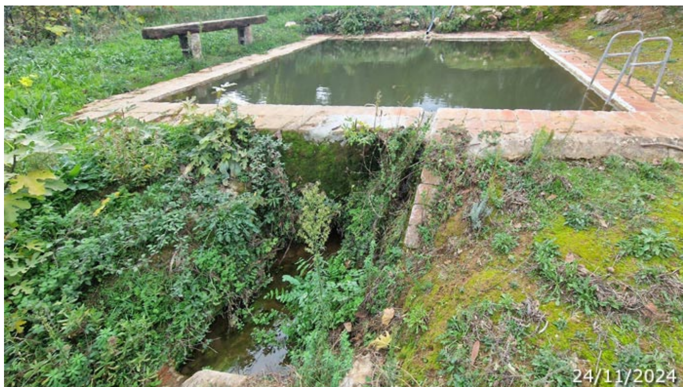
Arrojado del agua al exterior de la alberca, con todos los elementos descritos presentes (A. Ventas, noviembre 2024)
