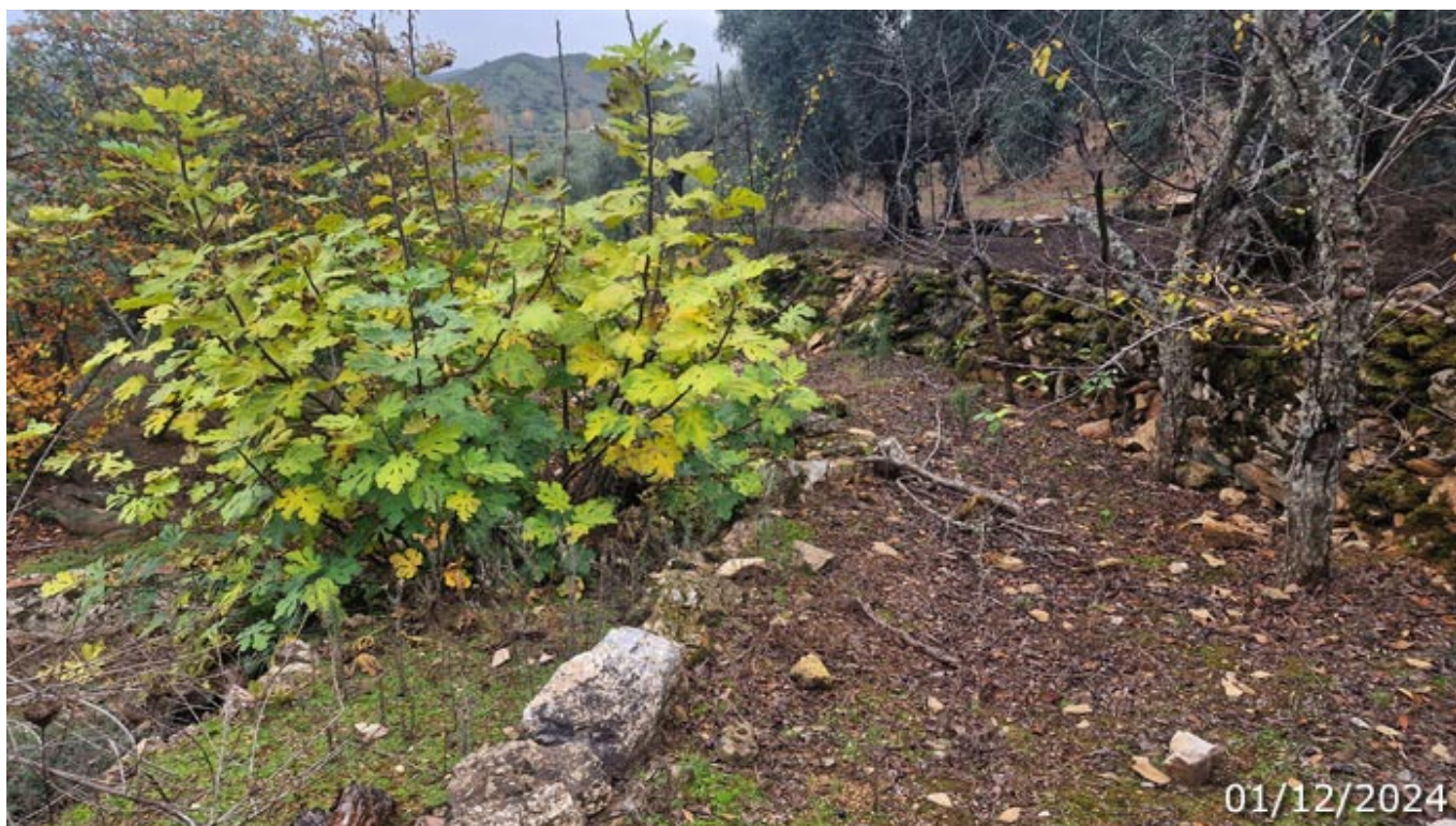
Muro de piedra seca tras La Posita, oculta por la higuera (A. Ventas, diciembre 2024)
