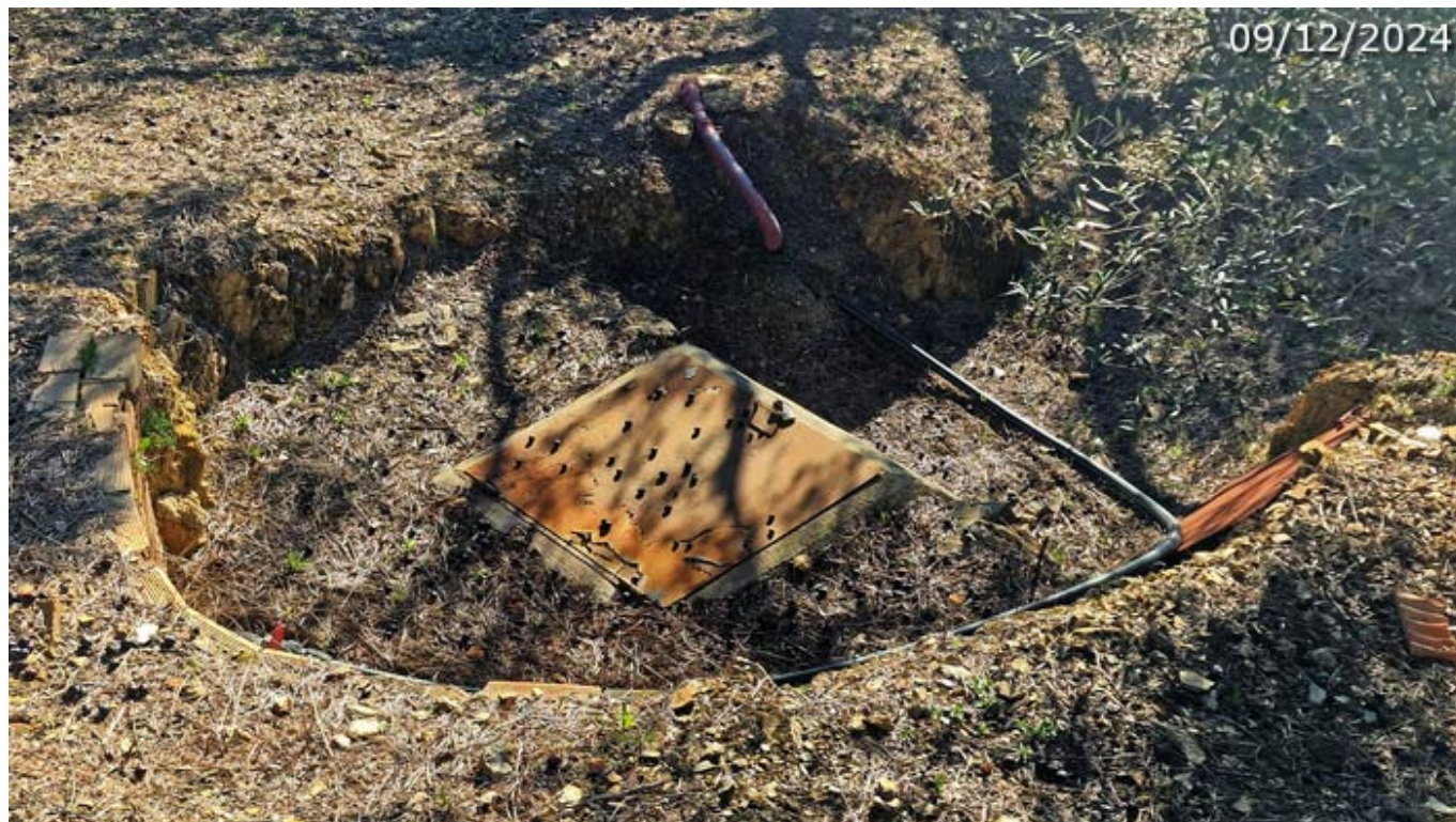
Nacimiento y arqueta de acceso superior, vistos desde arriba (A. Ventas, diciembre 2024)
