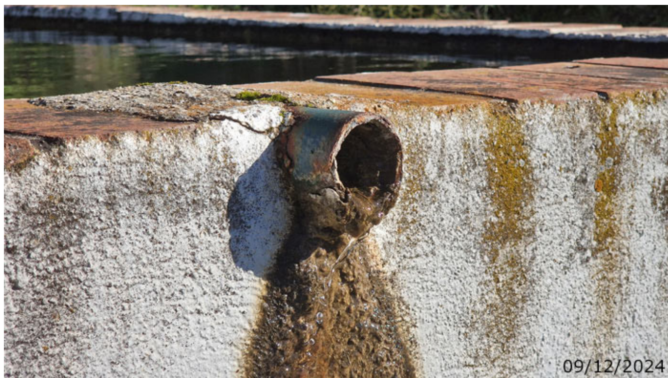
Caño del rebosadero, empapando la pared de agua (A. Ventas, diciembre 2024)
