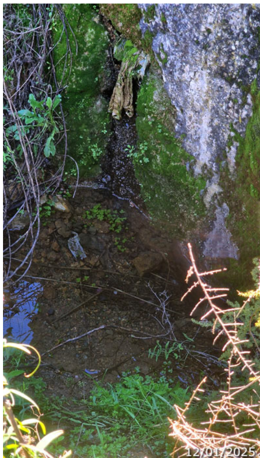
Grieta en la pared de la represa taponada con trapos y pérdida de agua (A. Ventas, enero 2025)
