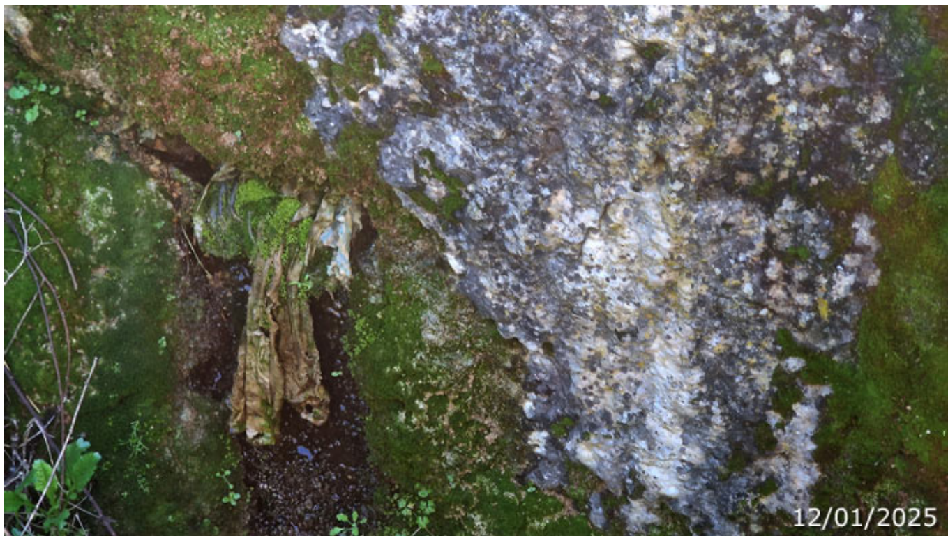
Detalle de la grieta taponada de la represa con un leve reguero de agua saliente (A. Ventas, enero 2025)
