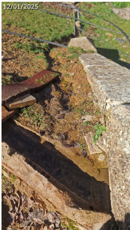
Derivación de agua desde la atarjea junto a la fuente (A. Ventas, enero 2025)
