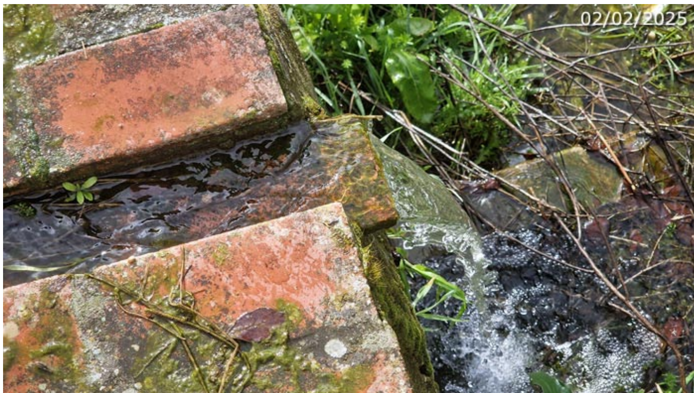
Agua saliendo por el rebosadero de la alberca a la pileta, abajo (A. Ventas, febrero 2025)
