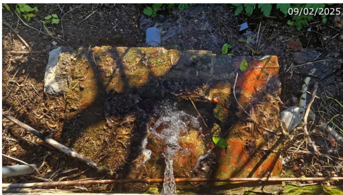
Pileta en el suelo recogiendo las aguas sobrantes de la alberca (A. Ventas, febrero 2025)
