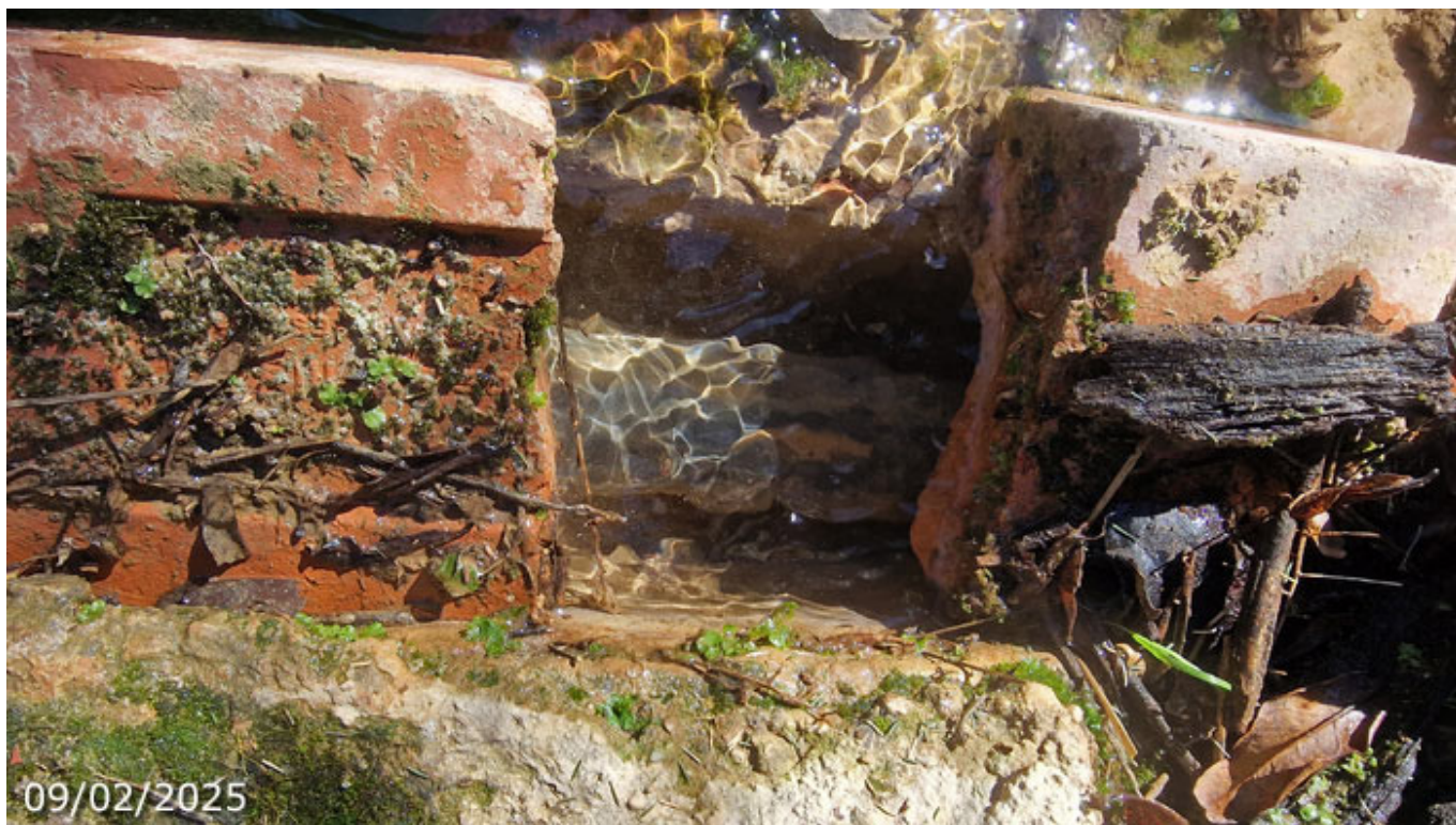
Atarjea desde la arqueta de captación, totalmente desbordado, con la conducción en su interior que lleva agua a la fuente (A. Ventas, febrero 2025)
