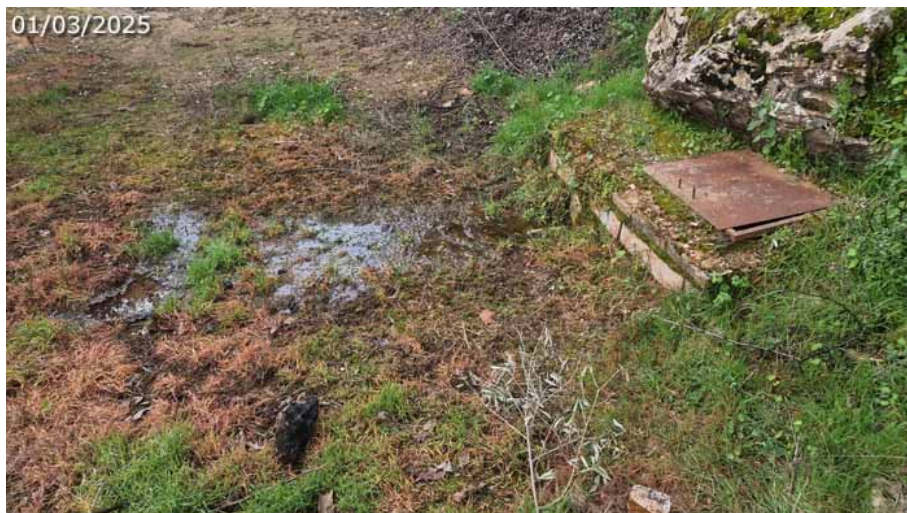
Fuente cubierta con una portezuela metálica (A. Ventas, marzo 2025)
