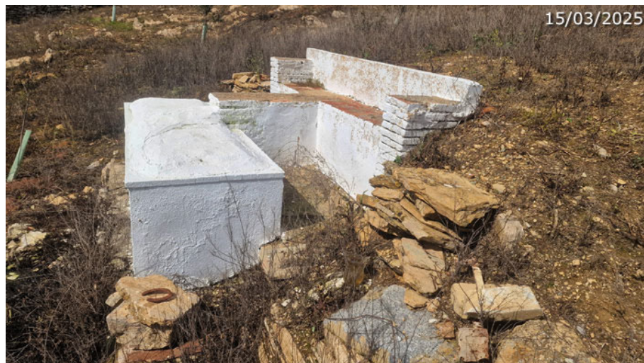
Fuente vista lateralmente, con la bancada, el pilar sellado y la arqueta en la parte inferior (A. Ventas, marzo 2025)
