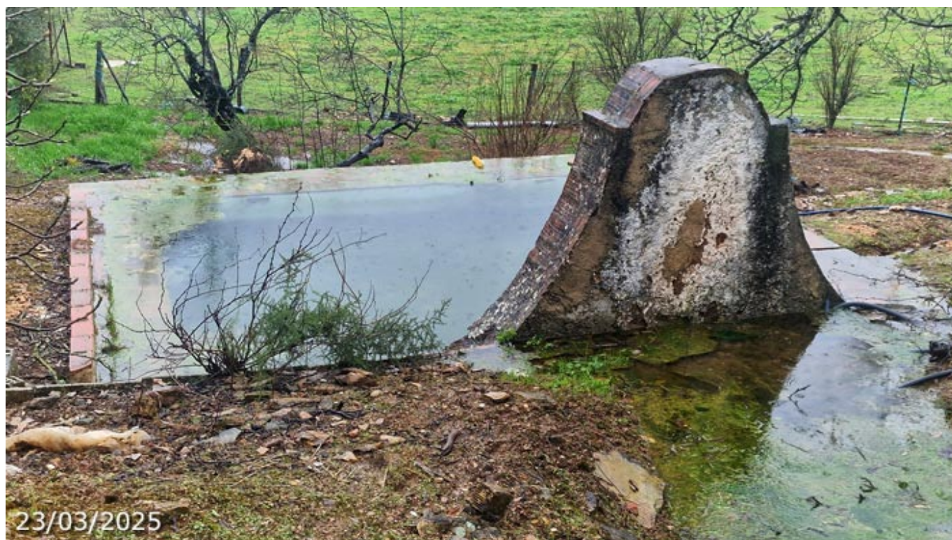
Agua entrando en la alberca por los laterales de la fuente (A. Ventas, marzo 2025)
