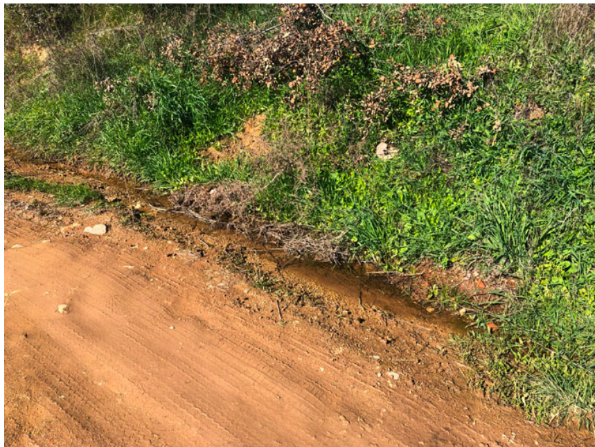
Localización del rezume en el margen del camino (C. Sánchez, febrero 2025)
