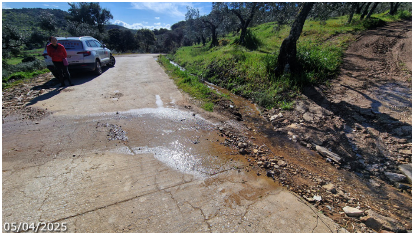
Camino de La Atalaya con las aguas de los diferentes rezumes cruzando el camino parcialmente (A. Ventas, abril 2025)
