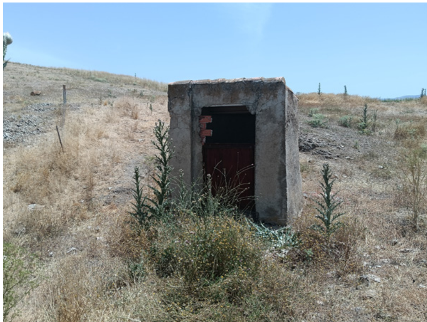
Vista de la caseta de captación (J. F. Martín Álvarez, junio 2026)
