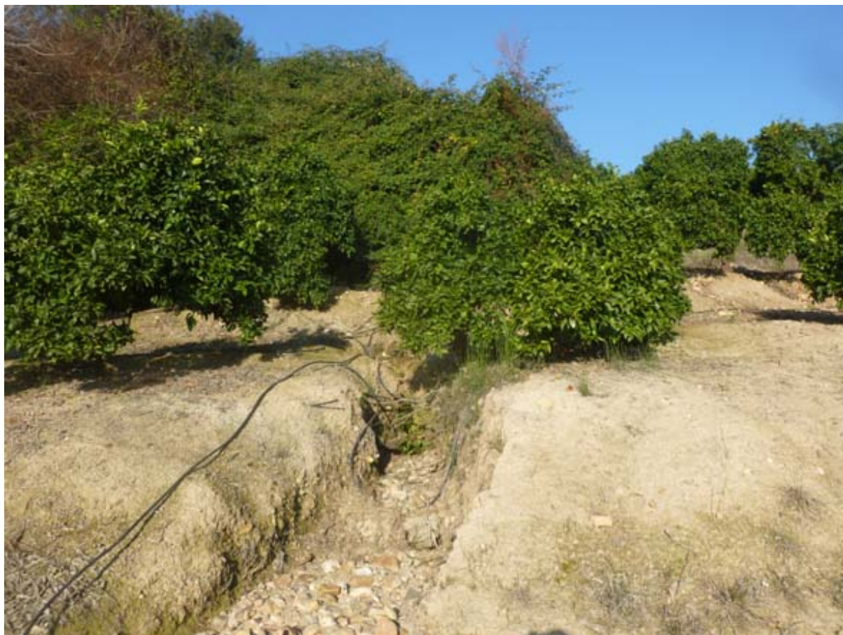
Erosiones por escorrentías de épocas de lluvias (R. Velasco Riejos, febrero 2020)
