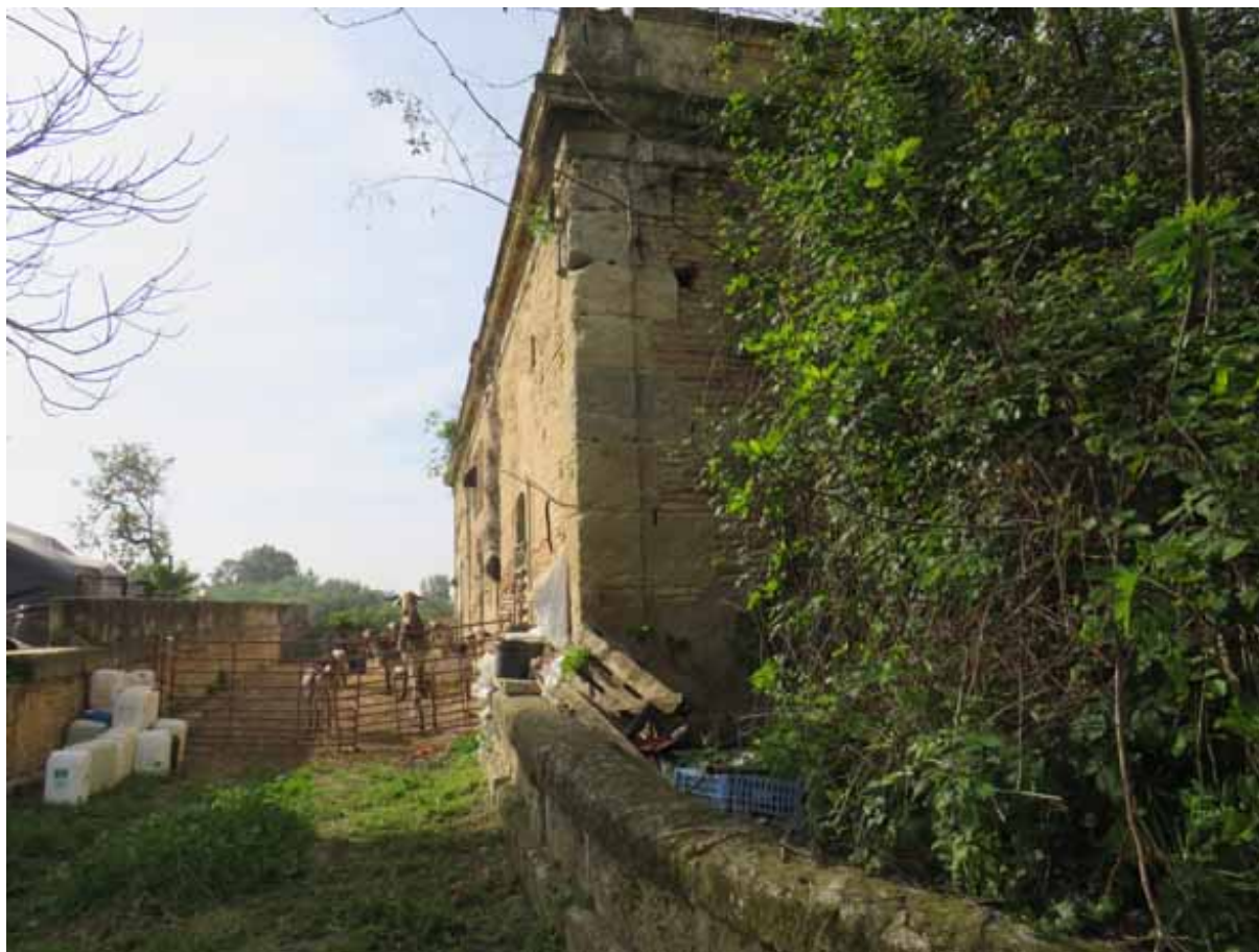
A la derecha, los telares anexos a la fábrica de harinas. Hoy edificios en estado de ruina y deplorable conservación (R. Velasco Riejos, marzo de 2020)
