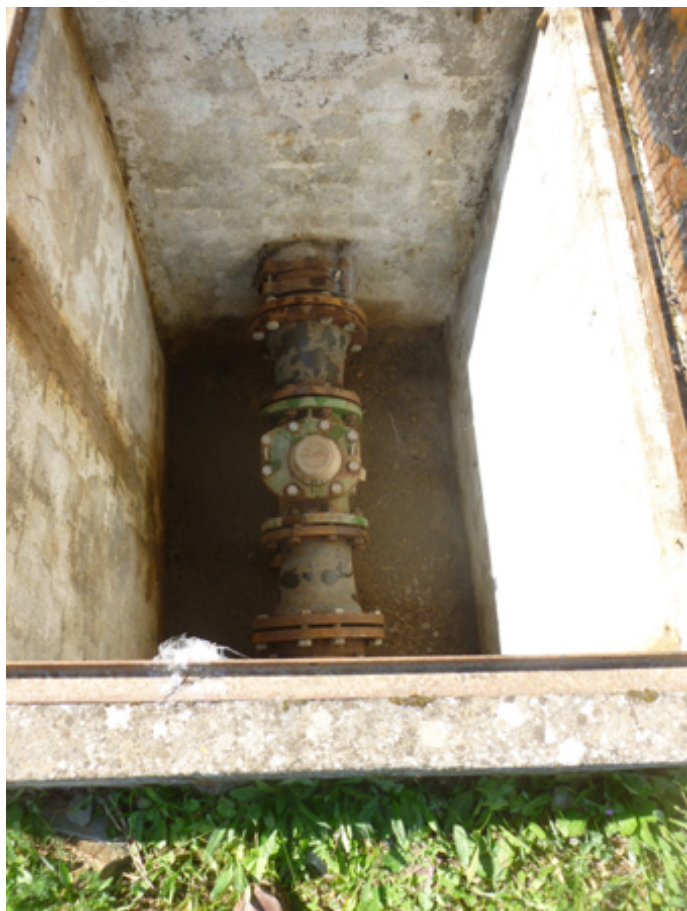
Registro con contador de la salida del depósito distribuidor (R. Velasco Riejos, marzo 2022)
